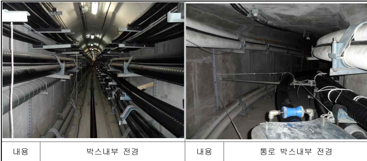
【사진 1.1】 구리인출 전력구 현황
