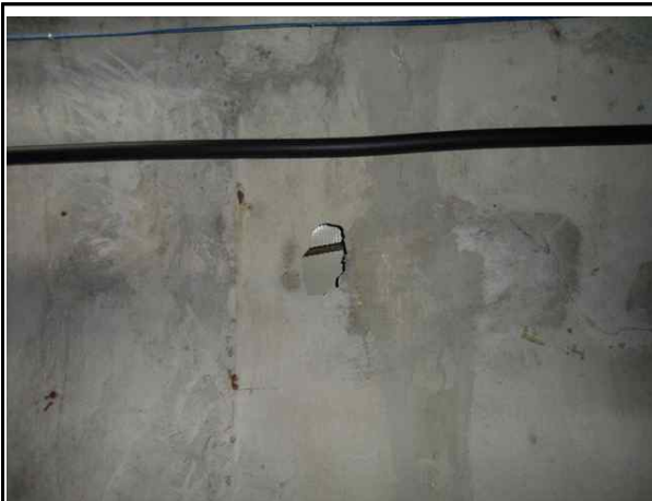
내용 상부슬래브 Sta.118m 철근노출
