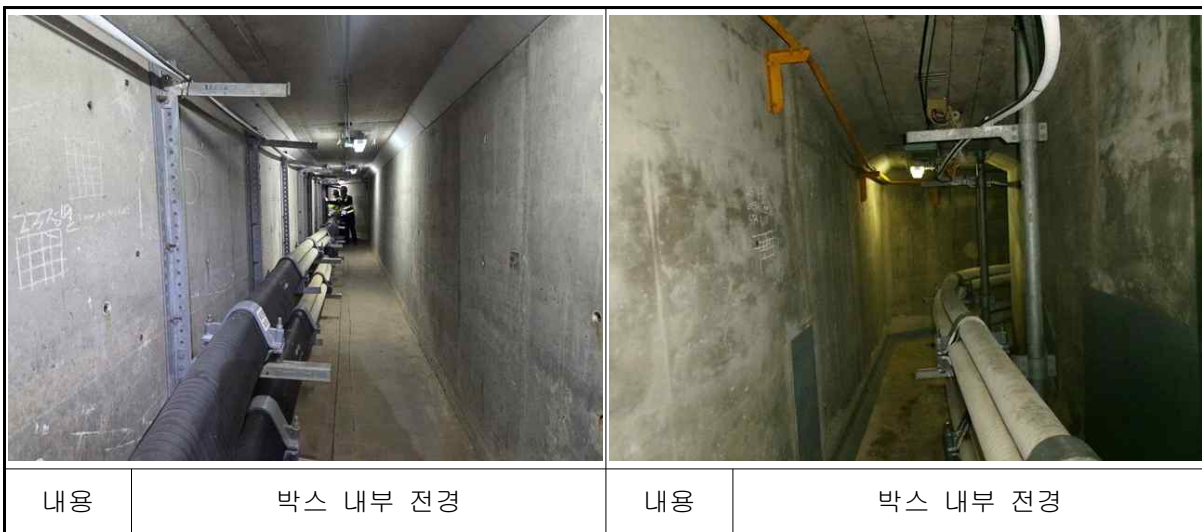
【사진 4.1】 송포일산인출 전력구 현황
