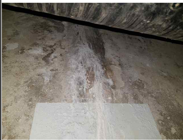
내용 우측 벽체 Sta.10m 백태
