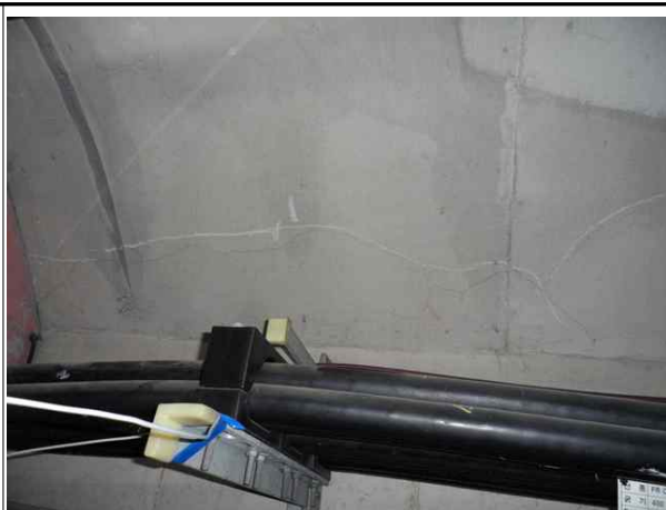
내용 상부 슬래브 Sta.120m 균열(0.3mm이상)
