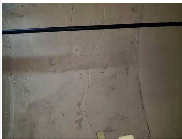
내용 상부 슬래브 Sta.24m 균열(0.3mm이상)
