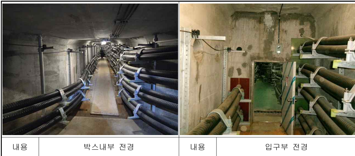
【사진 3.1】 문발SS인출 전력구 현황
