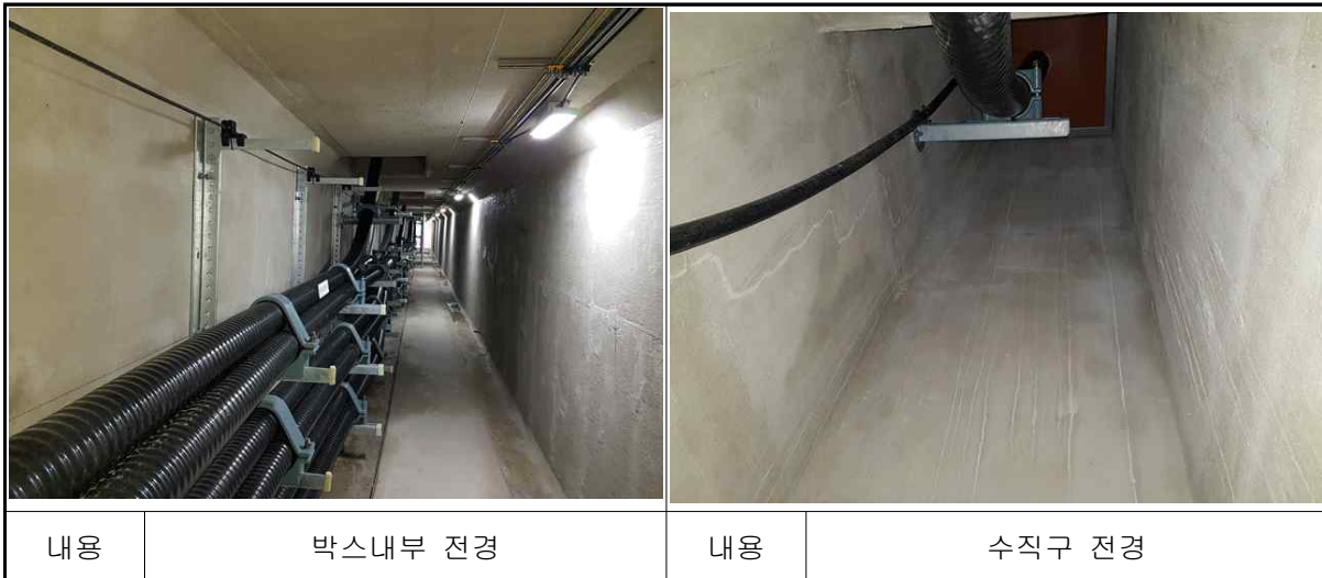
【사진 2.1】 포천인출 전력구 현황
